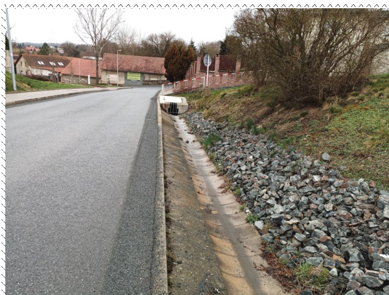
Koryto s odtokem do propustků a potoka
